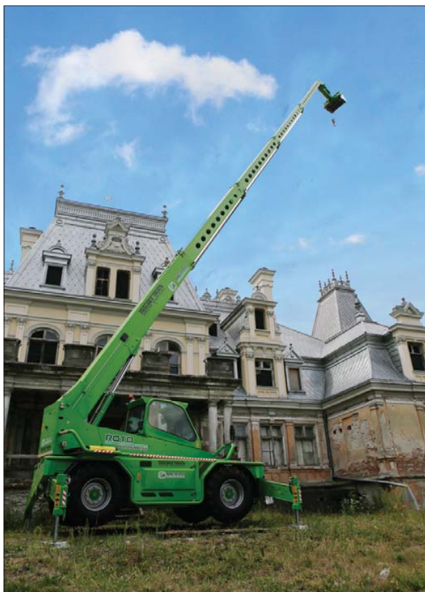
Odrestaurowanie takiego zabytku to nie lada wyzwanie. Na szczęście zielona maszyna wyposażona została w wysięgnik o długości 26 metrów
